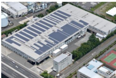
横浜工場 太陽光発電設備
